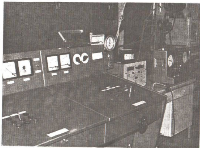
Рис. 3.4. Общий вид пульта управления тормозным стендом SAK-N 670 и экспериментальной установкой
